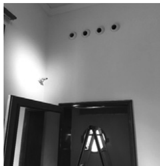
Die neue Klimaanlage
