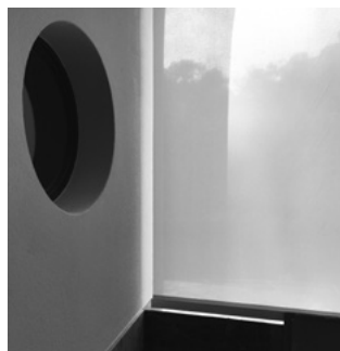
Der neue, in der Arkade montierte technische Vorhang
