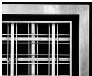
Detail der Heizkörperverkleidung in der Halle
