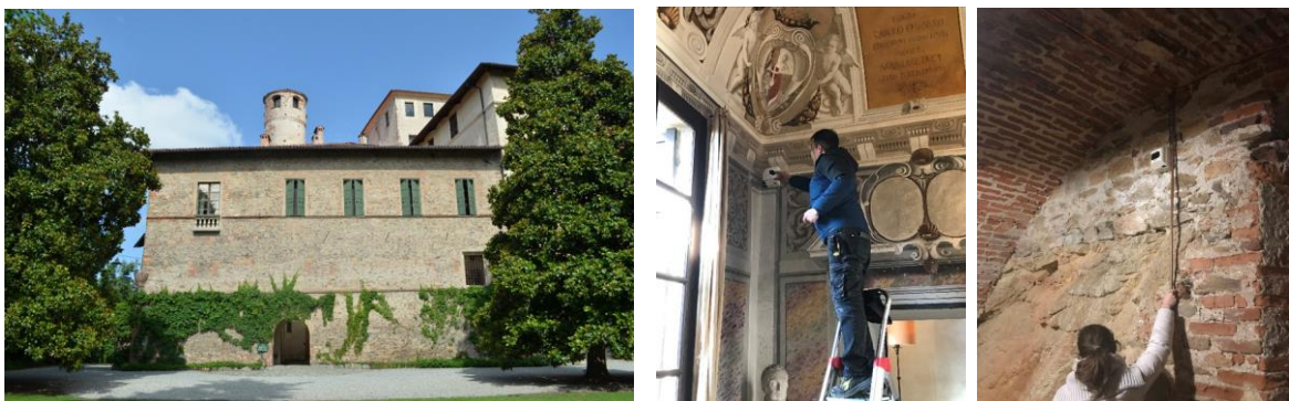
Veduta del Bene, posizionamento del rivelatore e posa delle reti di alimentazione
