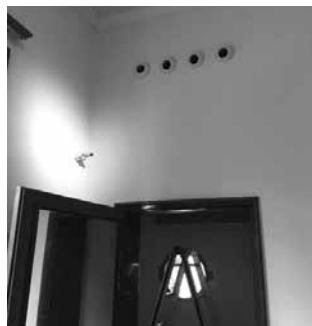
Il nuovo impianto di climatizzazione
